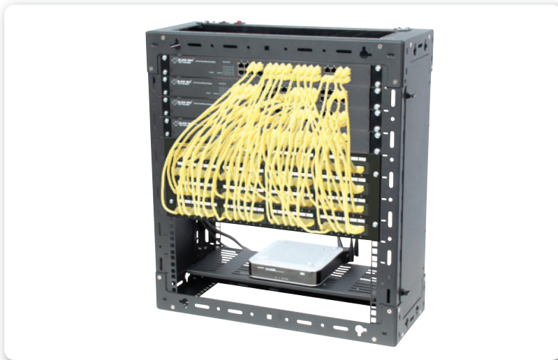
Figura 20. Los rack son elementos usados para establecer redes cableadas con servidores en determinados sectores.
